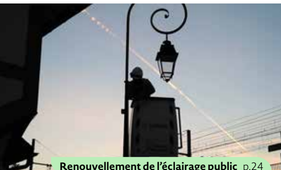
Renouvellement de l'éclairage public p.24
